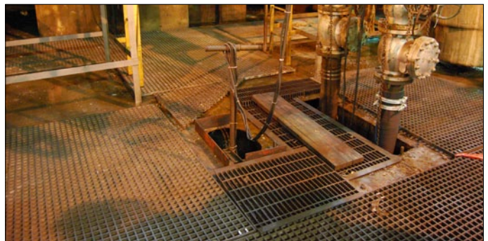
The Condensate pit
